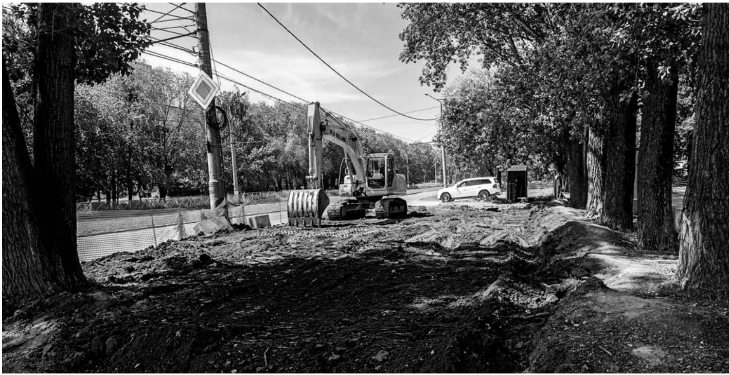
Один из проблемных участков Центрального района – бульвар 50 лет Октября на пересечении с улицей Победы. Жалобы пешеходов и автомобилистов на подтопление дороги здесь неоднократно поступали в районную и городскую администрацию. В этой связи АО «ПО КХ г.о. Тольятти» было принято решение о перекладке данного участка ливневой канализации протяженностью 54 п. м, с заменой пришедших в негодность железобетонных труб современными полиэтиленовыми аналогами.
