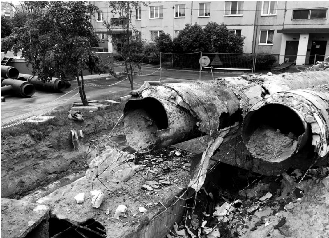
■ За последние годы нагрузка на городские сети водоснабжения и водоотведения возросла настолько, что при очередном катаклизме Автозаводский район может остаться без воды.
