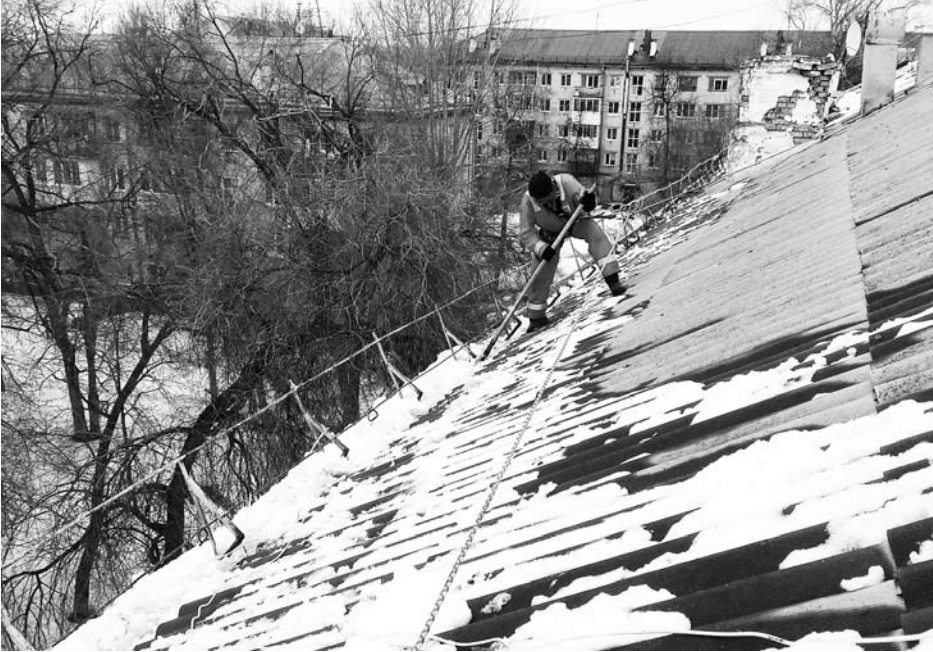
Игорь Зайцев: «Свободных денег у людей немного, поэтому собственники не спешат с очисткой крыш. И к весне на кровле нарастает наледь – 40–50 см чистого льда. Это огромная нагрузка. Лучше не откладывать подобные работы – чем толще лед, тем сложнее сохранить крышу от повреждения».
