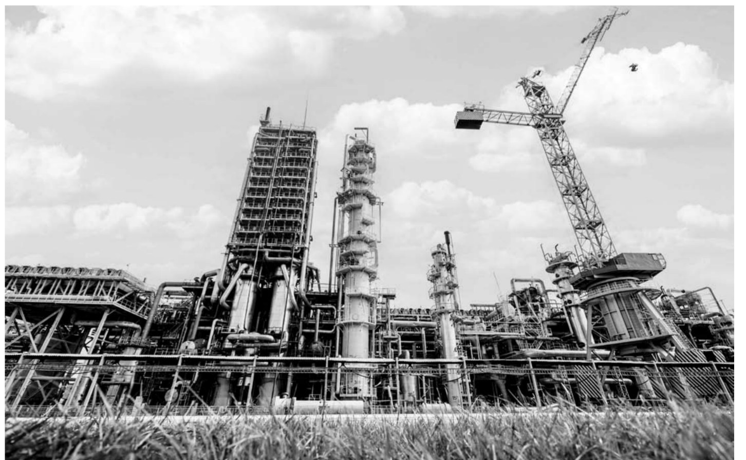
В ходе кампании запланирован комплекс работ по замене оборудования. В отделениях риформинга, конверсии и метанирования будет установлен новый катализатор. На регенераторе-ректификаторе абсорбционно-холодильной установки будут обновлены кипятильники. Еще одним важным этапом станет замена пароперегревателей обеих ступеней и подогревателя природного газа в конвекционной зоне печи риформинга.
